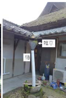
写真 5 樋に詰まった 雑草(F 邸)
