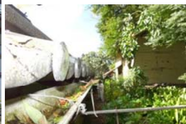
写真 6 樋にたまった落葉
