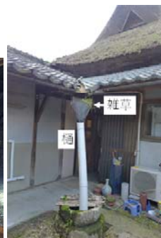
写真 5 樋に詰まった雑草 (F 邸)
