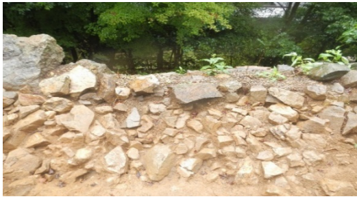
写真-4 土砂が混入した栗石層
