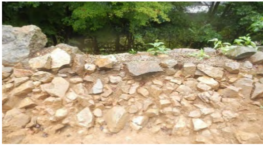
写真-4 土砂が混入した栗石層
