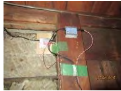
写真 3.2 渡邊家蔵の地震モニタリング
