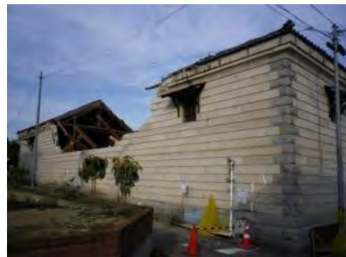
写真 3.4 東日本大震災で大破した奥山家住宅隣接の石造倉庫(国見町 HP より)
