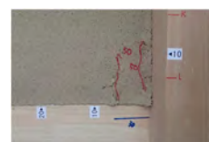
(a) 土塗壁隅角部の はらみ出し(+1/30 rad)
