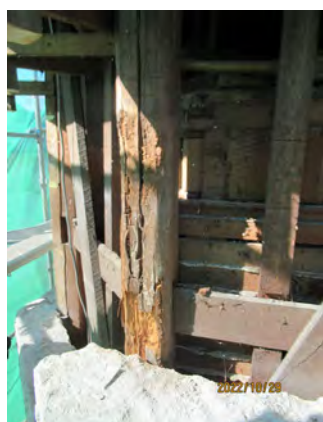
写真 3.10 石材間のずれの原因となった木柱の腐朽
