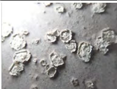
図1 大津壁の析出物を伴う劣化
