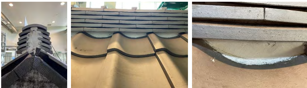
図7 瓦と南蛮漆喰の損傷観察
