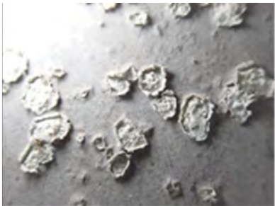
図1 大津壁の析出物を伴う劣化
