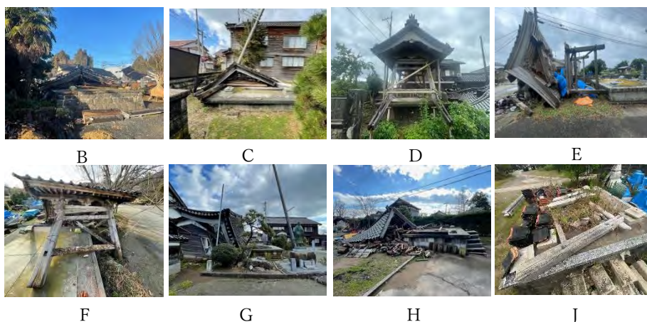
図 13 能登半島地震後の鐘楼の被害状況
