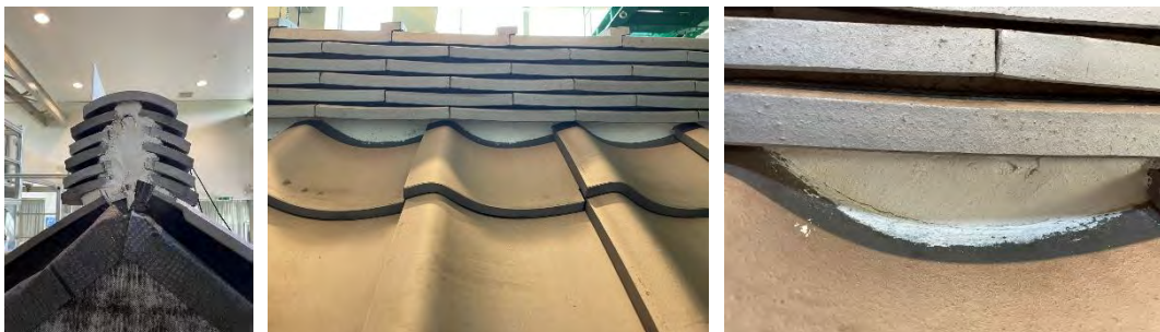
図7 瓦と南蛮漆喰の損傷観察
