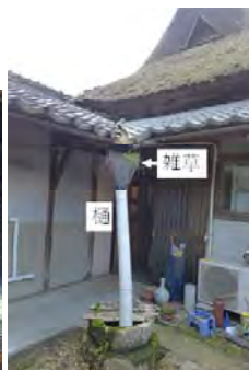
写真 5 樋に詰まった 雑草(F 邸)
