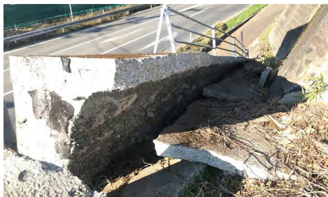
写真3 寺迫閻魔堂への階段が崩壊し2年半後もアクセスできない (2018年12月撮影)
